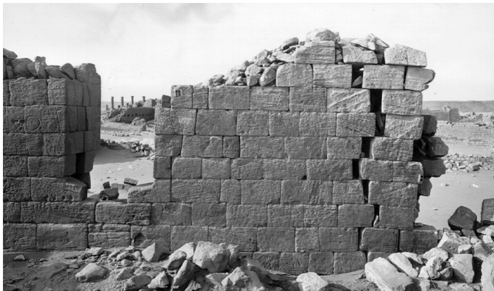
Musawwarat, Große Anlage: Meßbild einer gefährdeten Mauer
