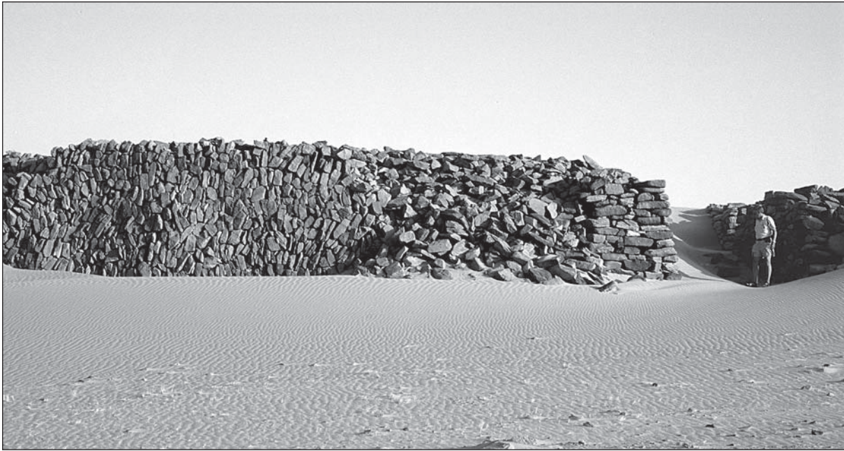
Abb. 4: Teilweise verstürzter Abschnitt der Mauer am Nordtor. Die unterschiedliche horizontale und vertikale Schichtung der Blöcke ist deutlich erkennbar.
