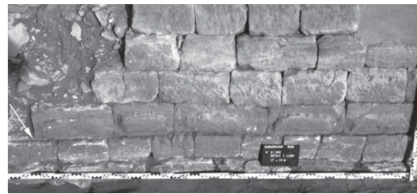
Abb. 36 In der Außenfassade sichtbare Risslinie (s. Pfeil) auf der 1. Lage, darüber Bossenblöcke mit von oben nach unten geringerem Abarbeitungszustand
