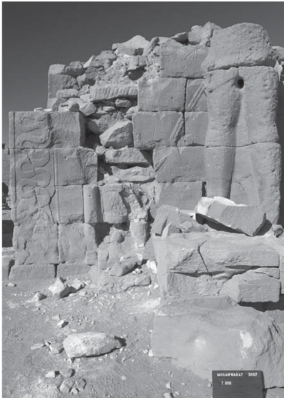
Abb. 16: Die zerstörte Löwenskulptur in der Südfassade.
