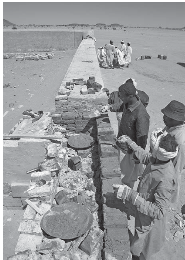
Abb. 8: Korrektur des Anstoßes der Mauerecke 304/E+304/307 an die Mauer 307/E.
