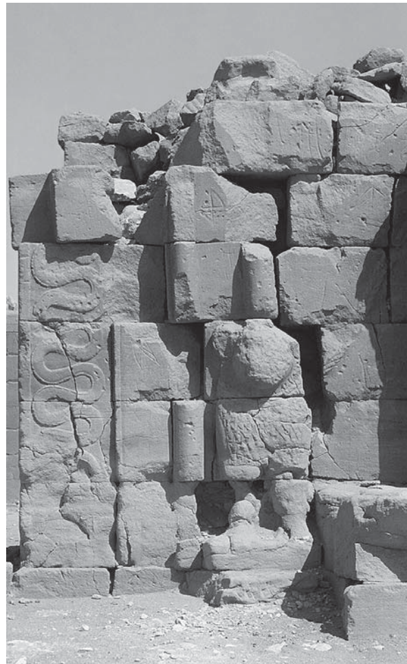
Abb. 27: Zustand der Wand im Jahre 2004, gekennzeichnet durch breite, ausgewitterte Klüfte und die stark verdrückte Position der Blöcke (Foto: Priese).
