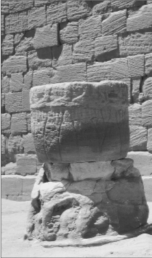
Abb. 8: Korrasionsschäden an der Ostseite des Zentraltempels der Großen Anlage (1995). Die Säulen- basis ist in Höhe der Oberkante der ehe- maligen Sanddüne fast vollständig ver- wittert. Im Hinter- grund Korrasions- schäden durch Sandschliff an der Ostwand des Tempels (Foto: P. Wolf).
