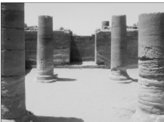
Abb. 4: Der Zentraltempel nach dem Sandaus- räumen im Frühjahr 1995. Ein Vergleich mit Abb. 3 zeigt die Konzentration der Schäden durch Salz- druckverwitterung und Korrasion in Höhe der ehemali- gen Oberkante der Sanddüne (Foto: P. Wolf).
