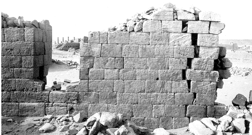
Musawwarat, Große Anlage: Meßbild einer gefährdeten Mauer.
