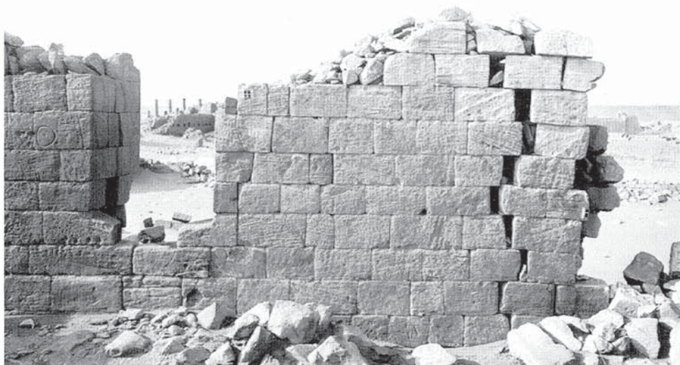
Musawwarat, Große Anlage: Meßbild einer gefährdeten Mauer.
